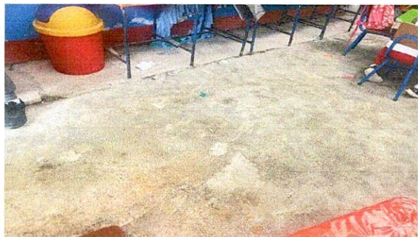
Mejoramiento de piso en ambas aulas por agrietamiento
