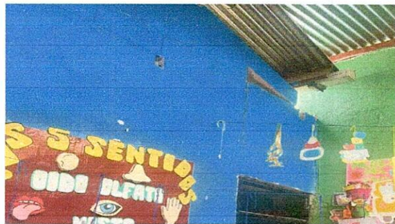
Subir altura de pared debido a que hay un canal y al momento de llover colapsa
